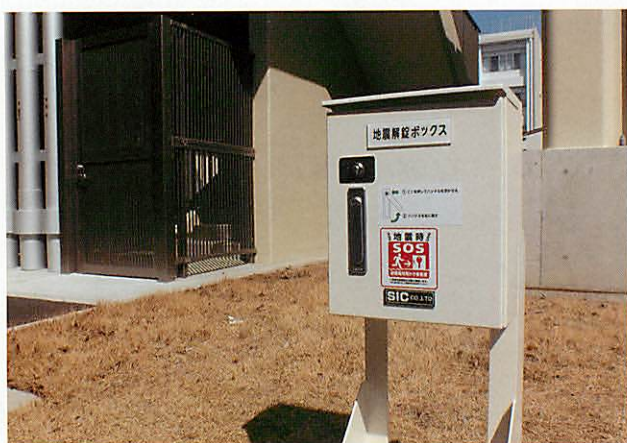
新病棟南東非常階段の感震解錠ボックス
