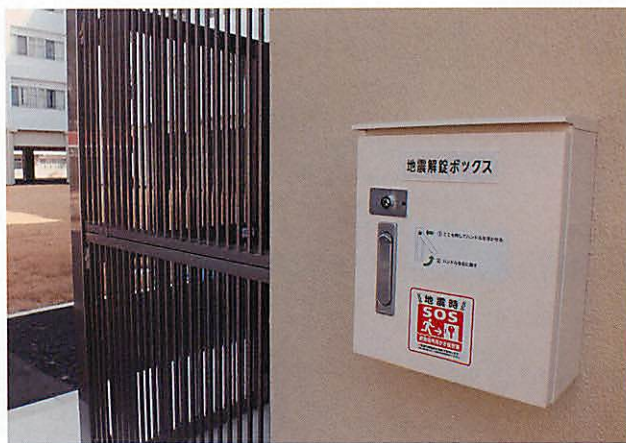
新病棟南西非常階段の感震解錠ボックス
